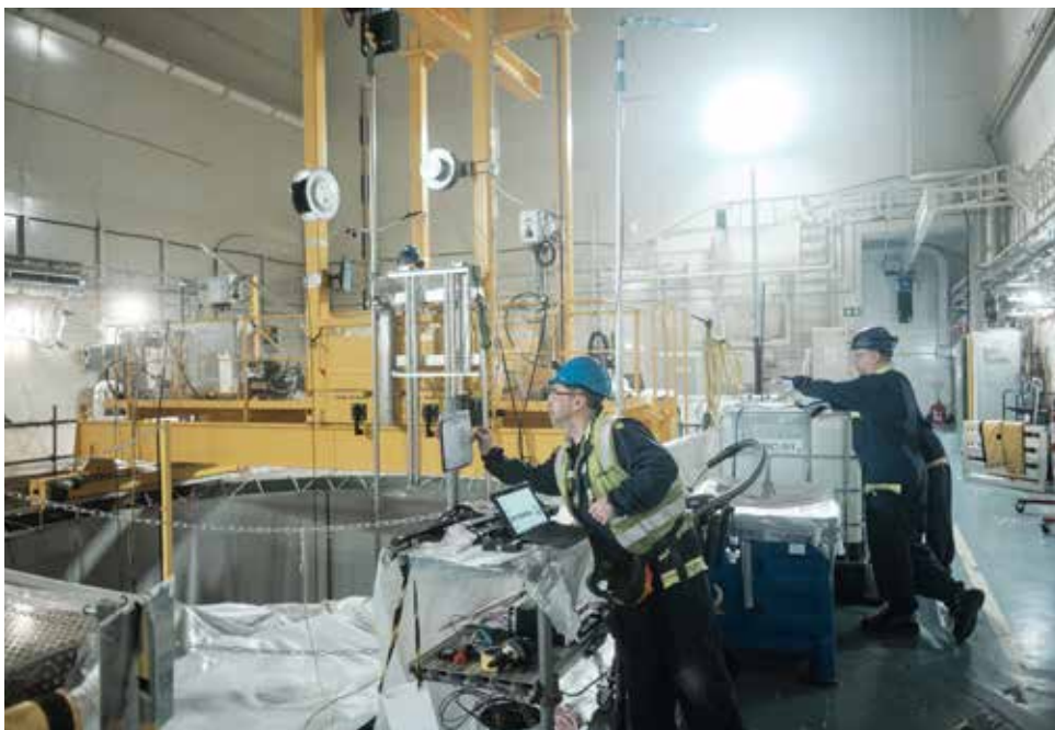
Samarbete och avstämningar kring arbetsbryggan som byggts för att kunna segmentera reaktortanken. Foto: Vattenfall/John Guthed
