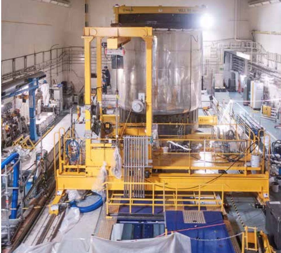
Reaktortanken har lyfts upp ur sin nedsänkta position för att den ska kunna segmenteras. Foto: Vattenfall/John Guthed
