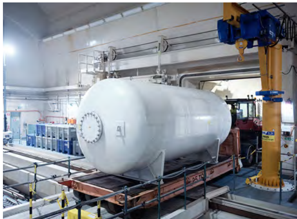
Tanken forslas ut från bergrummet inför transport från anläggningen. Foto: John Guthed
