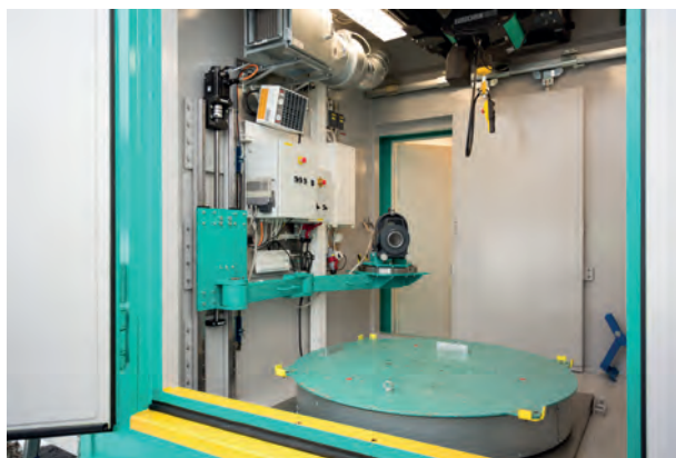
Ett av sätten att friklassa material är en mätstation där materialet placeras på en roterande platta där en högkänslig detektor läser av eventuell radioaktivitet. Foto: Vattenfall/Fredrik Ekenborg
