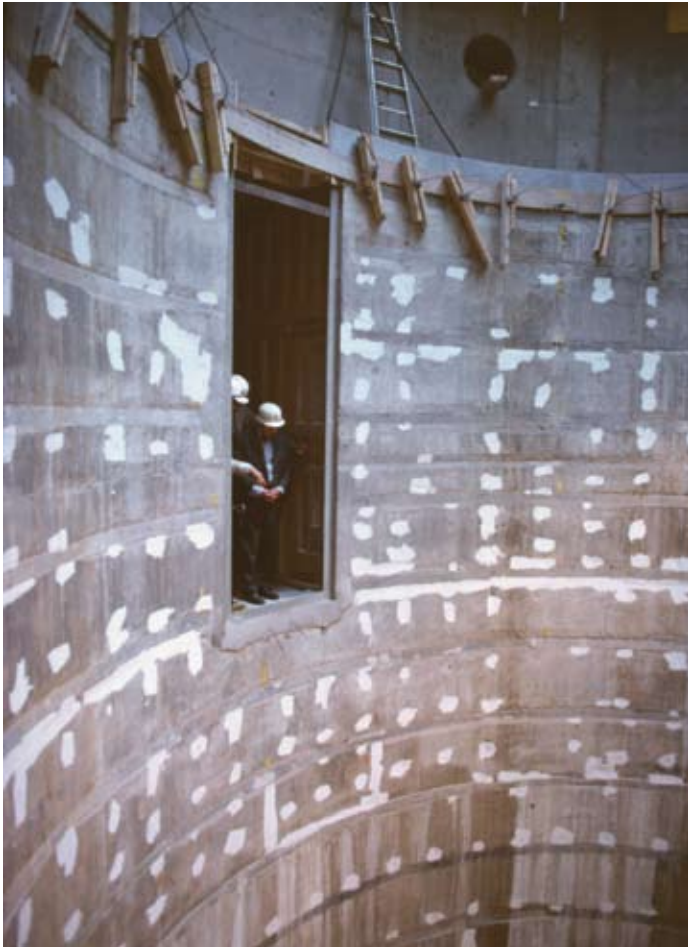
Byggchefen Oskar Rinne guidar Vattenfallchefen Jonas Norrby vid reaktorinneslutningen i Forsmark 2 i september 1975.
