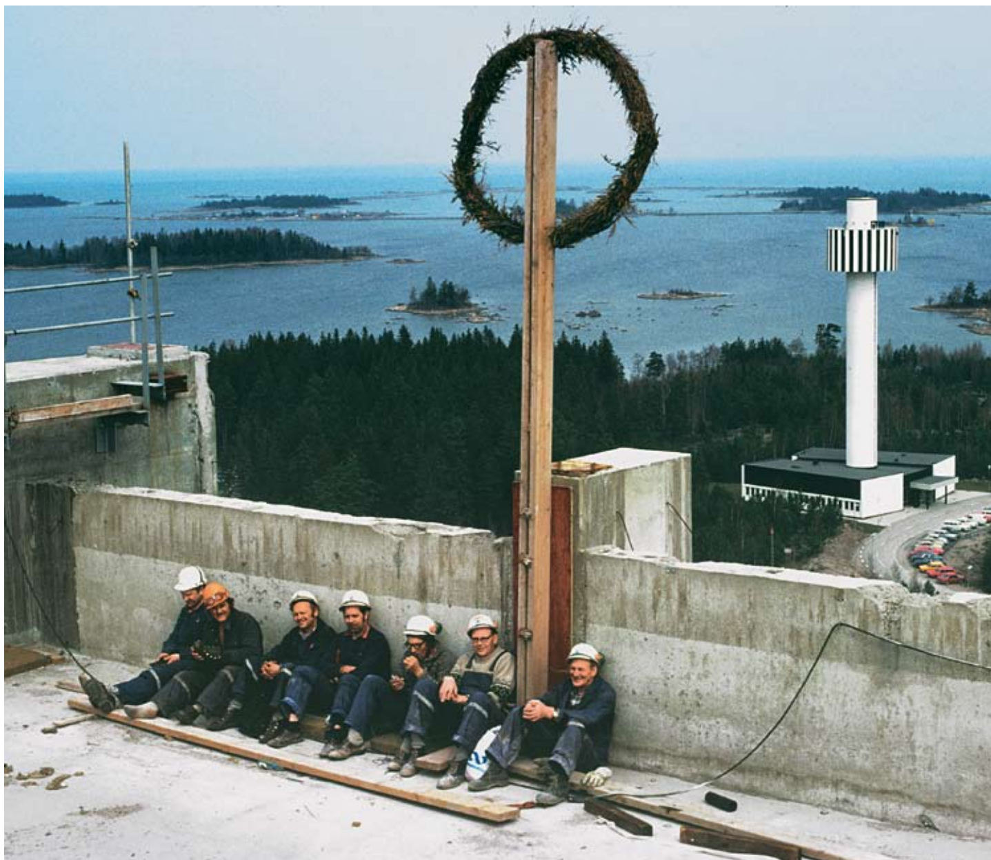
Snart dags för taklagsfest. Byggnadsarbetarna tar rast på taket till Forsmark 1, våren 1976.
