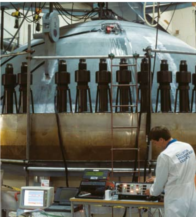
Spricksökning på reaktortanklocket på Forsmark 2 i juni 1990.
